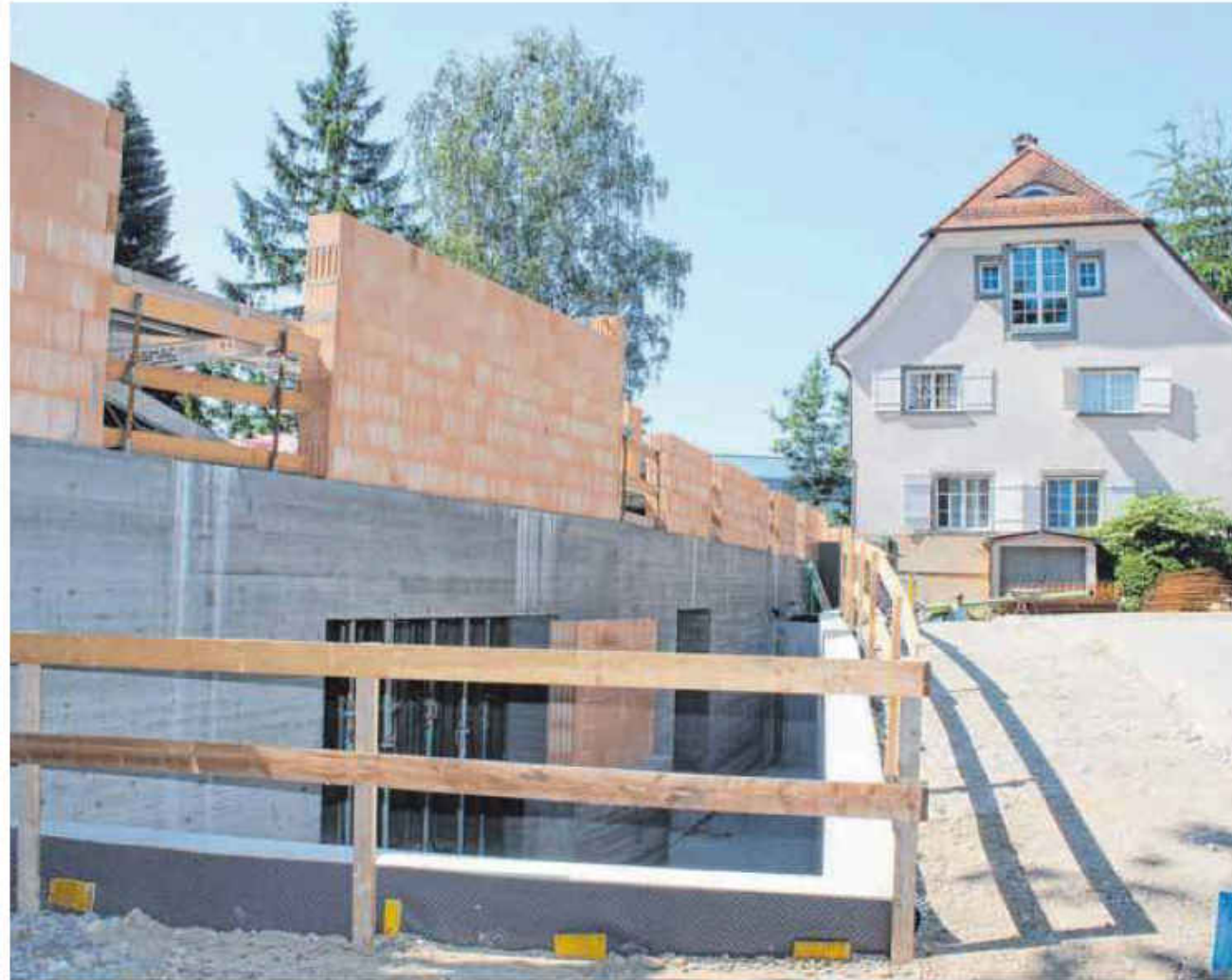
Ein stattlicher Anbau entsteht im Garten des stationären Hospizes Haus Brög zum Engel in Lindau.
