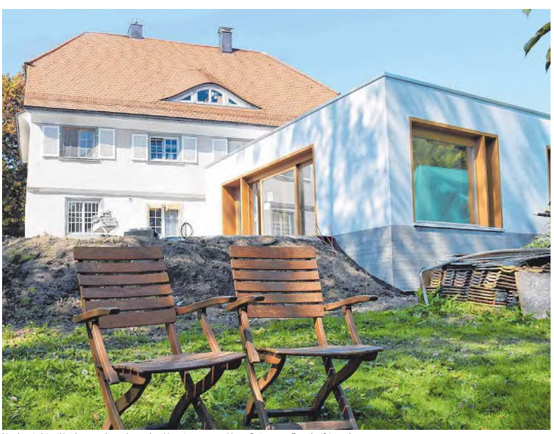
Noch wird im Neubau und rund um das Hospizzentrum Haus Brög zum Engel eifrig gebaut.
