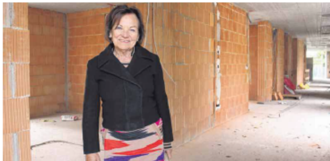
Halbzeit auf der Baustelle des Hospizanbaus: Vor einem Jahr war hier offizieller Spatenstich, der Baubeginn folgte im Januar 2015, im Sommer 2016 soll der Anbau fertig sein. Maja Dornier freut sich, dass der gestiegene Nachfrage nach Hospizplätzen entsprochen werden kann. FOTOS (3): RUTH EBERHARDT
